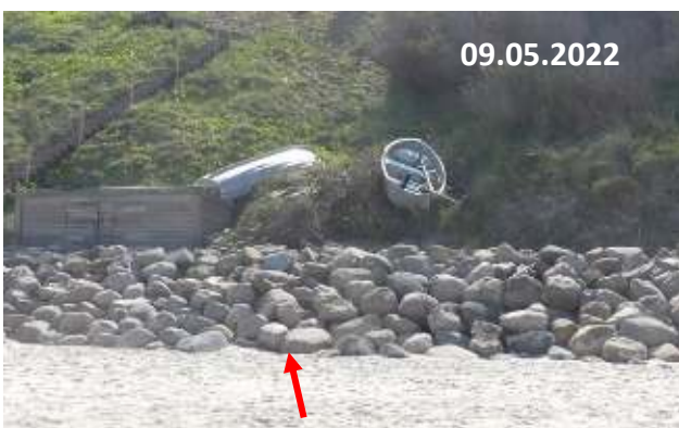
Skræntfodssikringen på den renoverede strækning bag høfde 3 i 2019, 2020 og 2021. Strandplanet næsten uændret.
