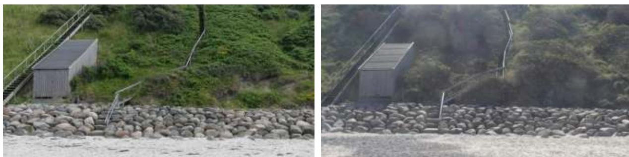
Skræntfodssikring og strandplan bag bølgebryder 8 i 2018 og 2022. Bemærk nederste trappetrin.
