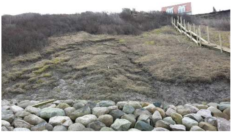
Figur 4-29 Jordskred på strækning bag bølgebryder 9.
