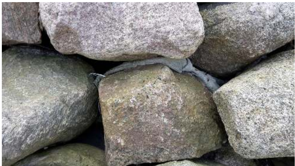
Figur 4-6 Eksempel på blottet filterdug i skråningsbeskyttelse på strækning bag bølgebryder 8.
