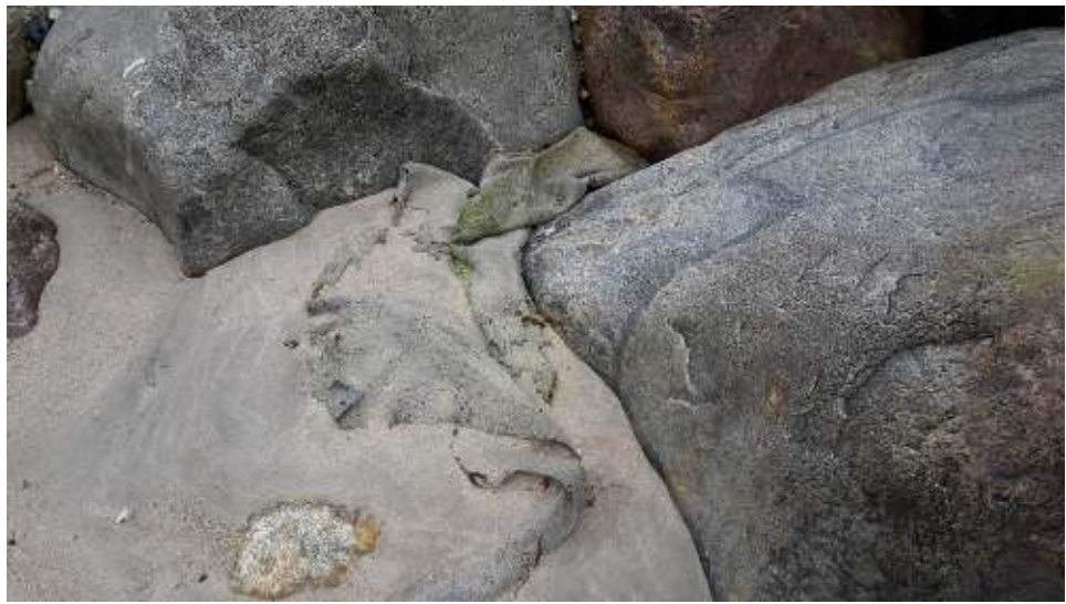
Figur 4-5 Eksempel på blottet filterdug i bølgebryder 13.
