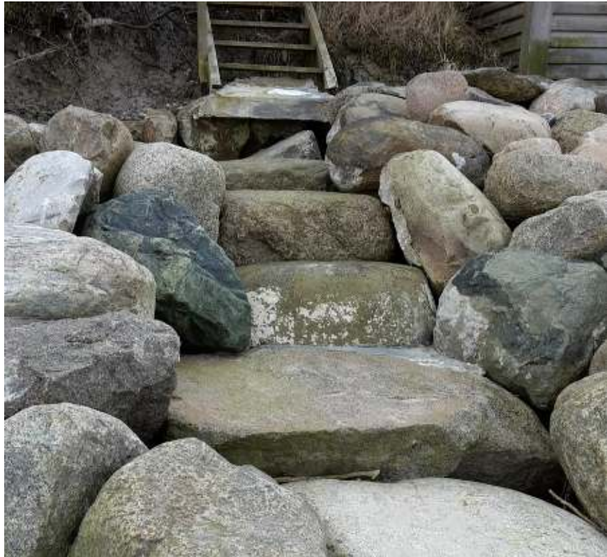
Figur 3-5 Trappe med undermineret betonplateau samt afslutning i trædesten. Strækning bag bølgebryder 4.
