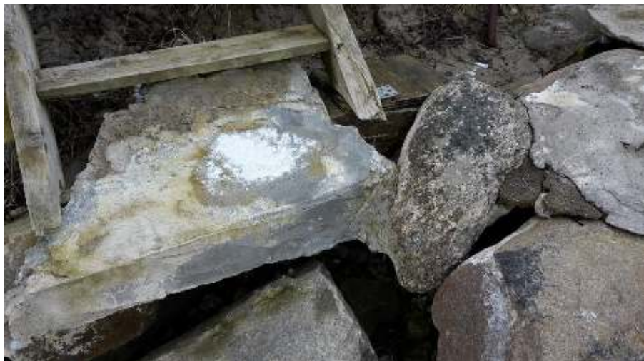
Figur 3-6 Trappe med undermineret betonplateau samt afslutning i trædesten. Strækning bag bølgebryder 4.
