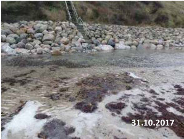
Erosion under INGOLF mellem bølgebryder 5 og 6
