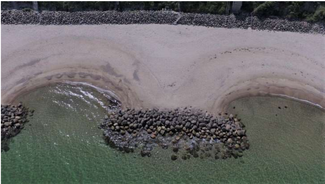
Bølgebryder 8. Bemærk spredningen af sten på havsiden. Som observeret sidste år blev denne bølgebryder væsentligt beskadiget under stormen URD.
